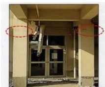
【学校施設被害状況 2】
