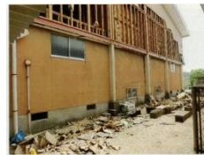
【学校施設被害状況 4】
