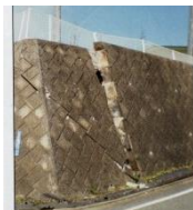
【学校施設被害状況 3】
