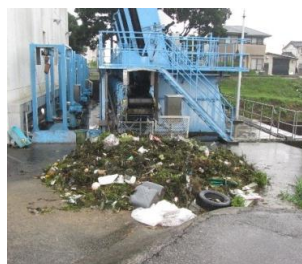
ポンプ場にたまるゴミの様子
